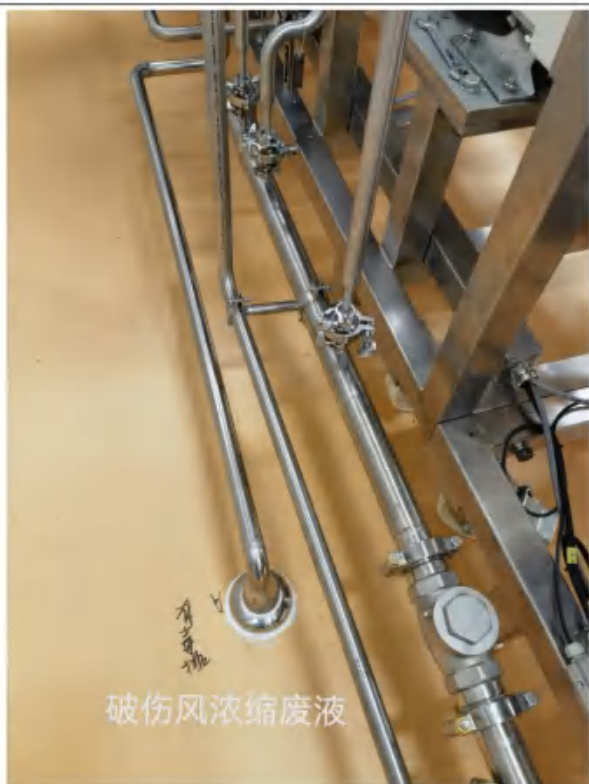
破伤风浓缩废液管道
